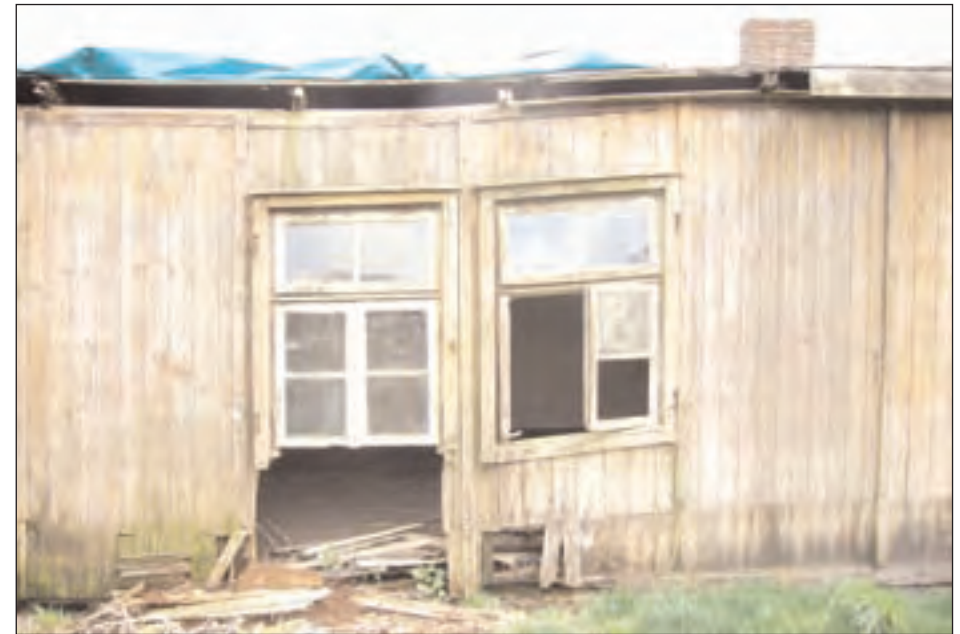
Zeitspuren am ehemaliger Unterkunftsbaracke vor der Sanierung
